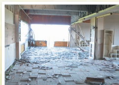
天井がはがれた教室
