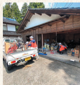
被災ゴミを運び出している様子
